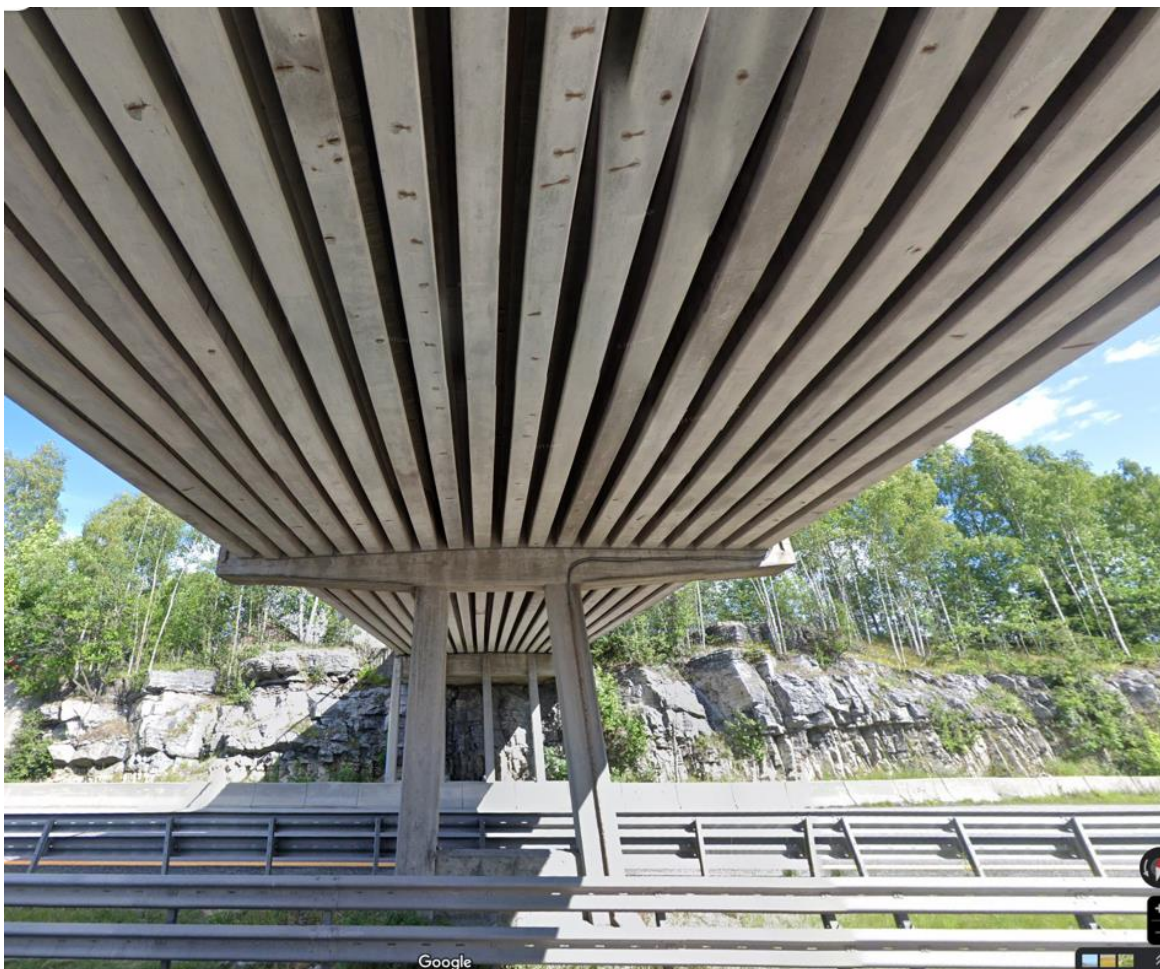
Figur 13 Skade nr. 5. Underkant av prefabrikeerte betongbjelker med avdekket, korroderende armering.
