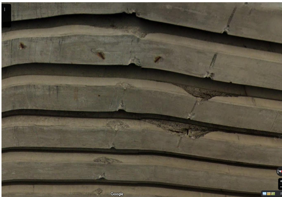
Figur 11 Skade nr. 4. Påkjøringsskader i underkant av prefabrikkerte bjelker over nordgående kjørefelt.
