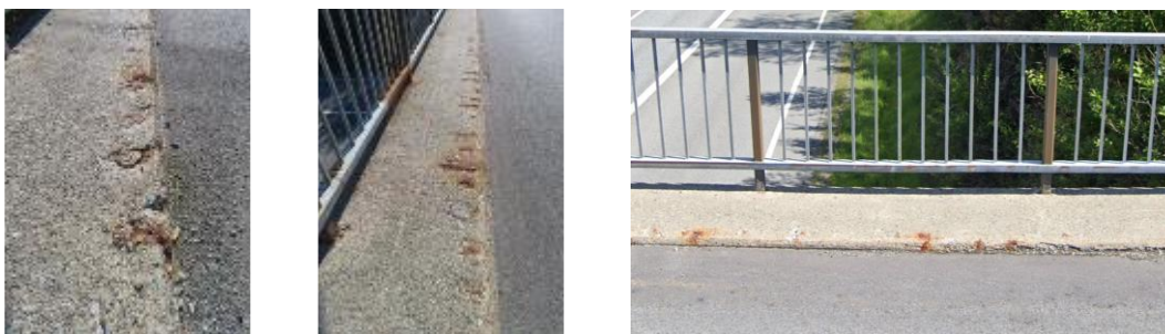
Figur 9 Skade nr. 6. Frilagt korroderende armering på fortau/bankett på begge sider av brua.
