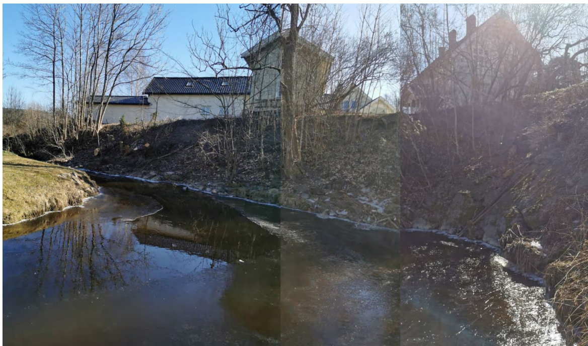
Figur 39 Elvesvingen ved Kjellstadveien 18. Sammensatt kompositt av bilder fra (DMR Miljø og geoteknikk, 2022). Tydelige utglidninger langs skråningstoppen. Nedre elvekant i yttersvingen forsterket med sten.
