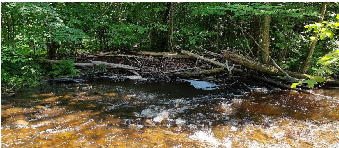
Figur 12 Tilstopping med trær og busk av flomløp i elveleiet nedstrøms Bru 4.
