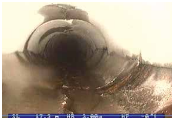
Bilde 26: Rør som er i ferd med å kollapse på grunn av høyt trykk eller dårlig rørkvalitet. Foto: Hendrik Panman, Kjeldaas AS
