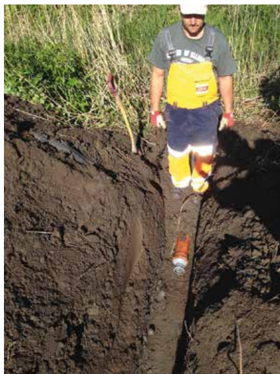
Bilde 36: Påkobling av stivt utløpsrør uten perforering gjennom vegetasjonssonen og ut i kanalen. Foto Atle Hauge
