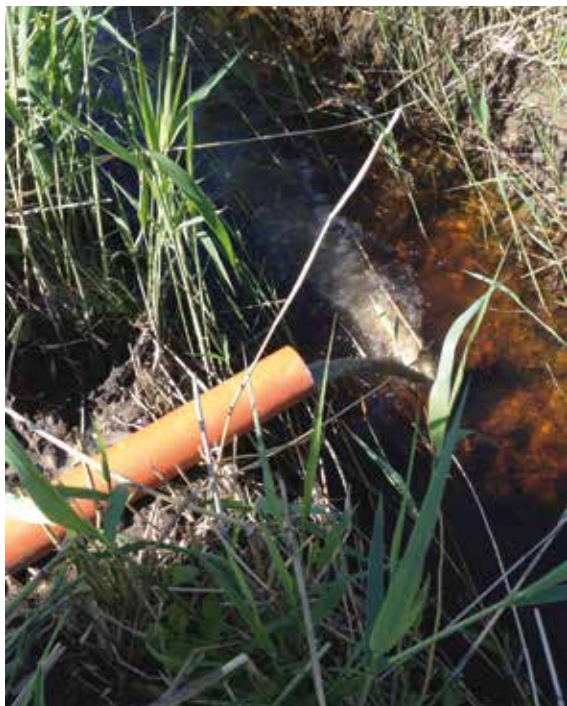
Bilde 37: Stivt utløpsrør med drypphøyde sikrer gode utløpsforhold. Foto Atle Hauge
