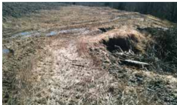
Bilde 5b: Etter hvert kan en få kraftig utrasing i skråningen.
