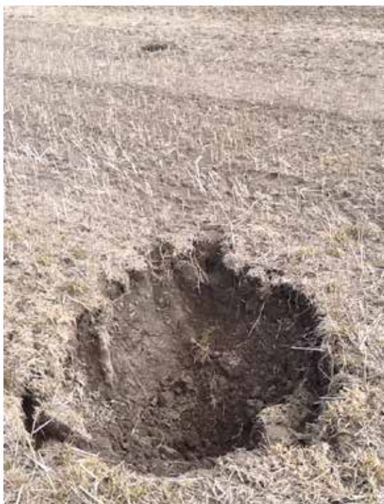
Bilde 24a og 24 b: Rørledninger kan ha større eller mindre lekkasjer, som viser seg som jordhull på overflaten. Mindre jordhull kan oversees noen år, men problemene vil forsterke seg etter hvert.
