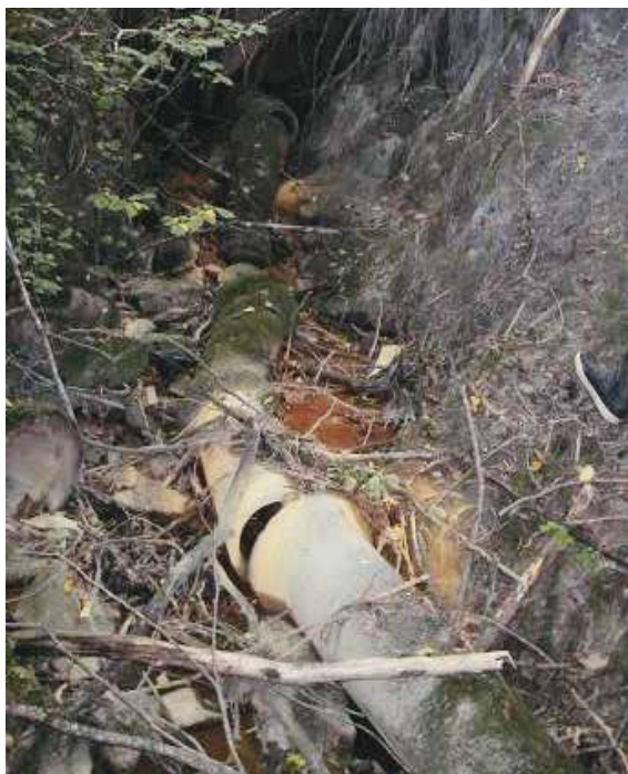
Bilde 39: I utløpet begynner vann å renne ut av skjøtene og langs rørgata, og det er ikke uvanlig at ett eller flere rør er vasket ut.
