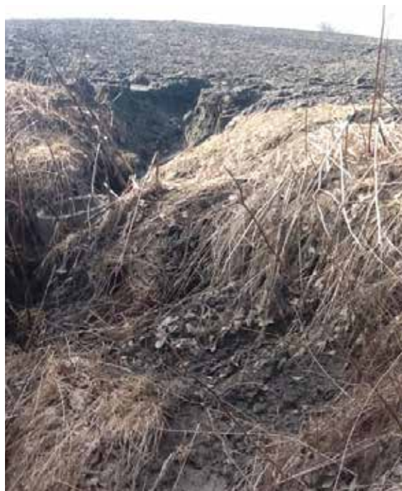
Bilde 12a og 12b: Plassering av kum i åkerkant for å fange overflatevann og føre ned til sikkert dyp er anbefalt, men der kummen er utett kan en få erosjon rundt kummen, og fullstendig kollaps av systemet.
