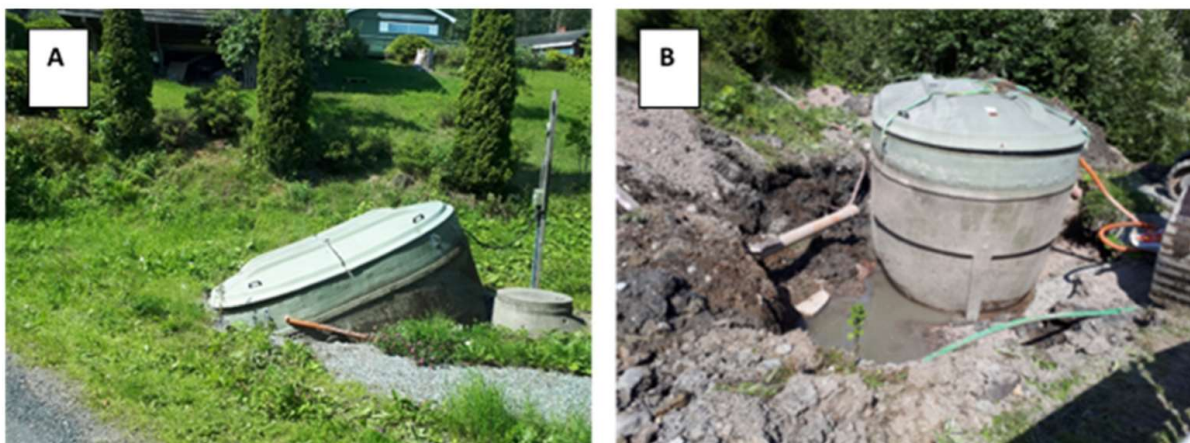
Figur 2: Her har et Klargester minirensesanlegg for syv boenheter fått skader på grunn av oppdrift. Anlegget fløt opp etter slamtømming (bilde A), før slamtømmer rakk å tilbakefylle vann i anlegget. På tross av en tørr sommerperiode sto det vann rundt anlegget (bilde B) fordi dreneringen ut fra byggegropa hadde tettet seg.
