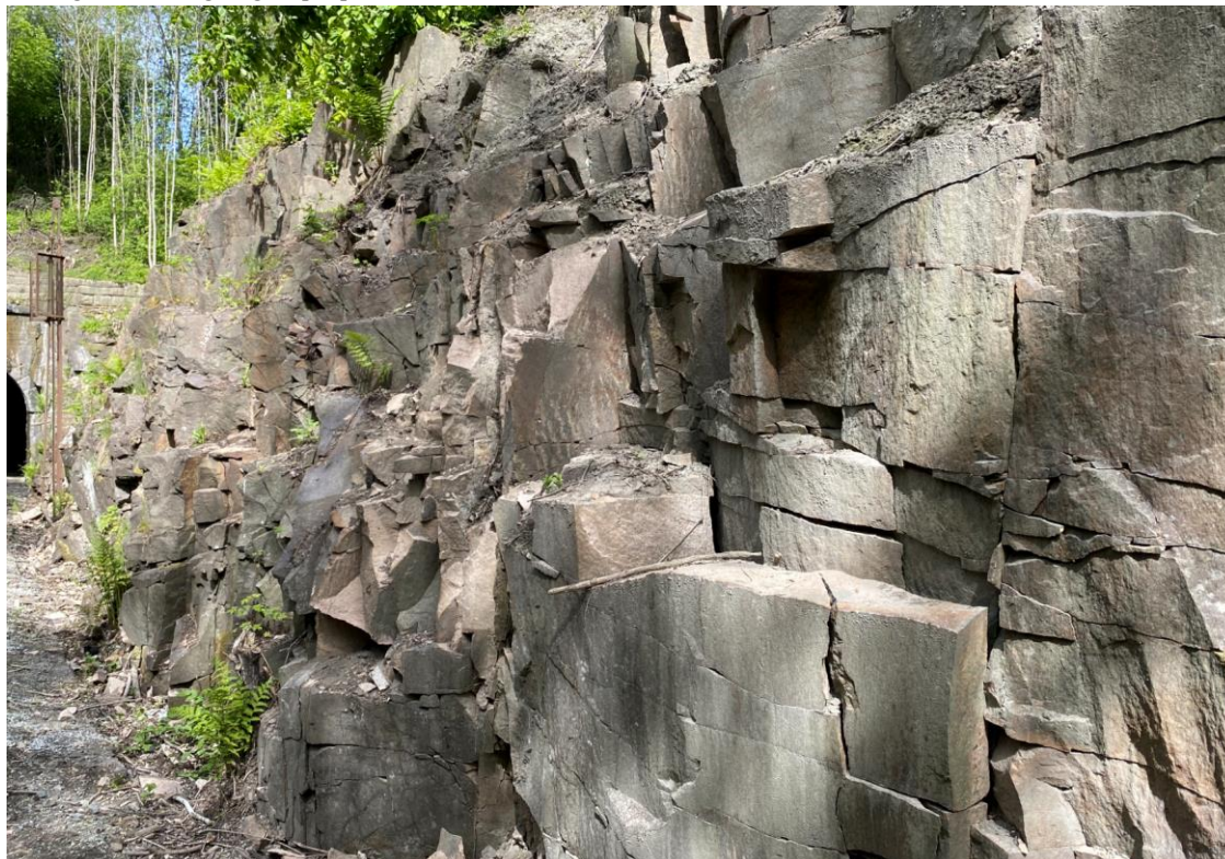
Figur 5-17 Kubisk oppsprekking som ofte finnes i Drammensgranitten, med 2 –3 steile sprekkese sett samt 1 subhorisontale. Bilde tatt ved påhugg vest for Kovedstadttunnelen.
