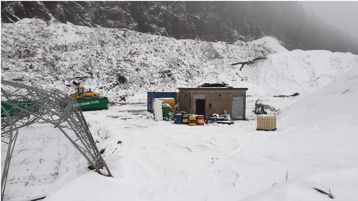
Figur 9. I bakgrunnen vises oppfylte masser mot bergvegg i øst. Midt på bildet vises en teknisk bygning hvor det er lagret blant annet en del kjemiske produkter på utsiden.
