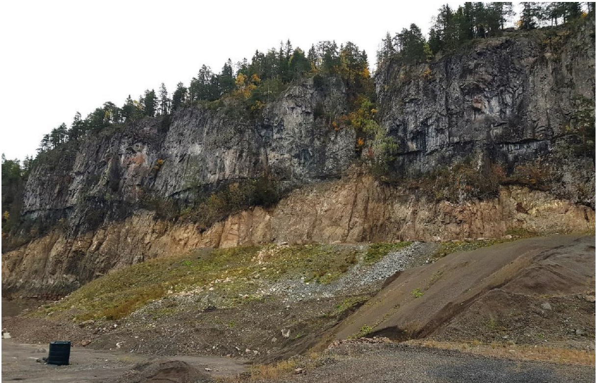
Figur 3-4: Bilde av bergveggen som danner planområdets østre avgrensning. Bildet viser hvordan ura under bergveggen har blitt tatt ut. Dette området er synlig som et gult felt på bergveggen.
