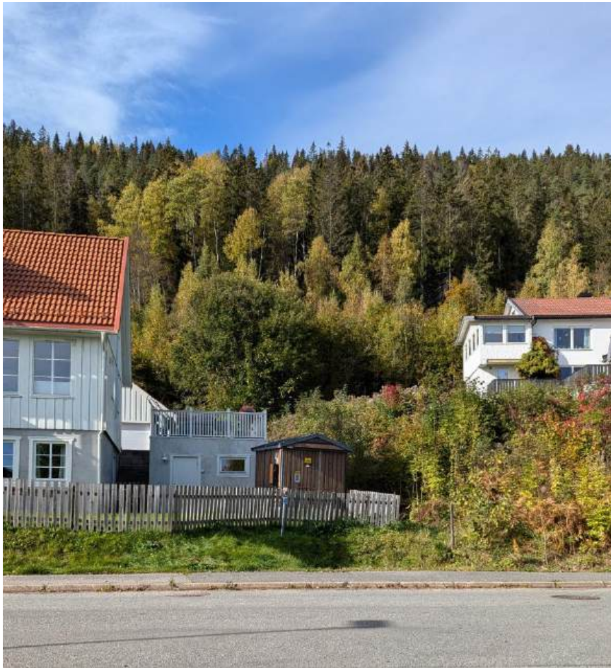
Figur 31: Eksisterende trafo langs Sognaveien.
