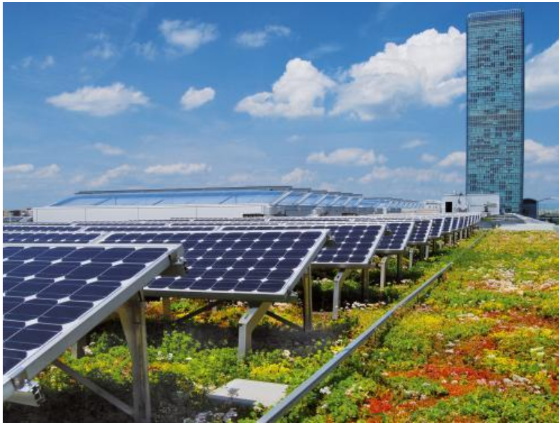
Figur 4-7 Solceller i kombinasjon med sedumtak.
