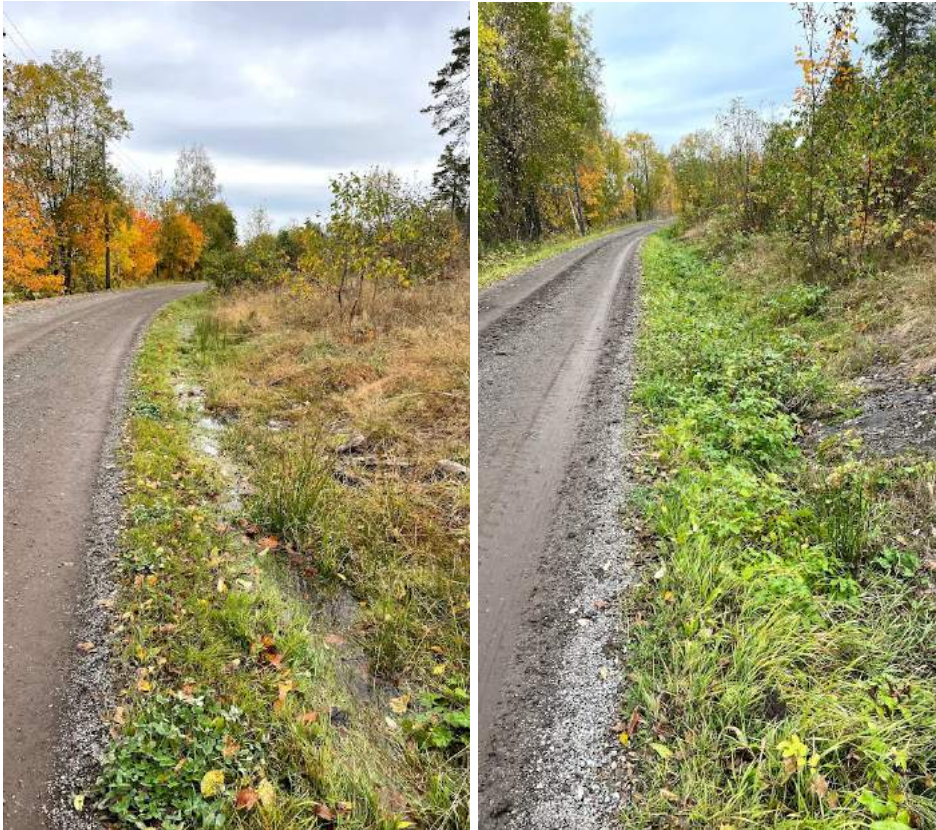
Figur 18: Befaringsbilder i Gamle Ringeriksvei sett mot nord i retning vannføringen. Overvannet fra Eplegrenda renner på oppsiden av veien.
