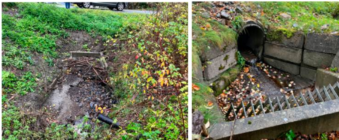
Bildet til venstre viser at kulvert under fylkesveien er tettet igjen med kvist og grus. Bildet til høyre viser kulvertutløpet nedstrøms fylkesveien og inntaket til den private kulverten (Foto: BFK)
