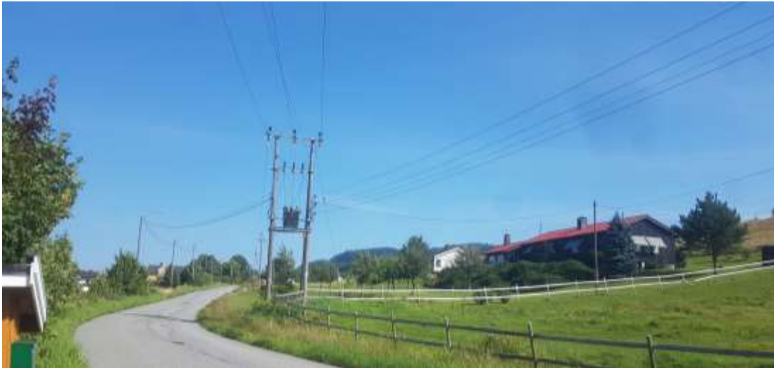
Figur 11: Bilde som viser transformator opphengt i stolpe.
