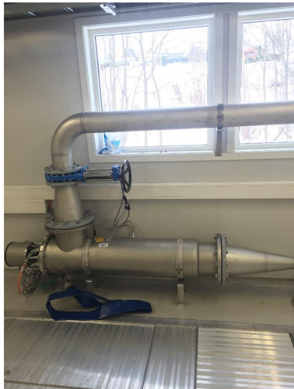
UV-anlegg ved Sylling renseanlegg. Bildet viser en av to enheter i parallell og med gjensidig reserve for hverandre.
