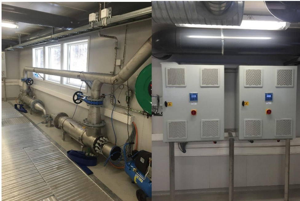
Bildet viser begge de to parallelle aggregatene.
