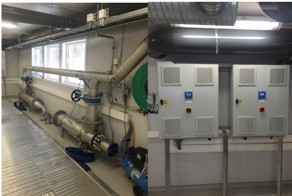
Bildet viser begge de to parallelle aggregatene. Styreskap for UV-aggregatene.
