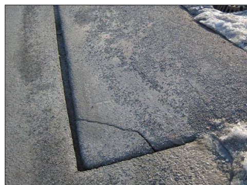
Åpen skjøt pga. manglende klebing og fortanning.
