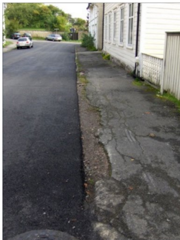
Manglende prioritering av gående ved dekkelegging.
