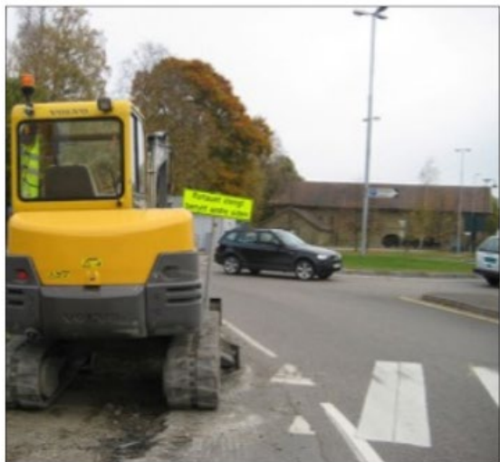
Manglende hensyn til de myke trafikanter.
