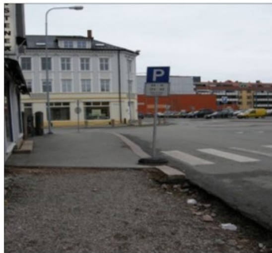
Manglende avsperring av arbeidssted.
