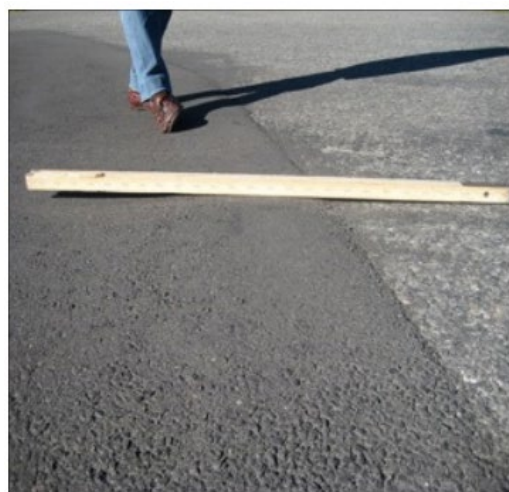
Nivåsprang mellom nytt og gammelt veidekke
