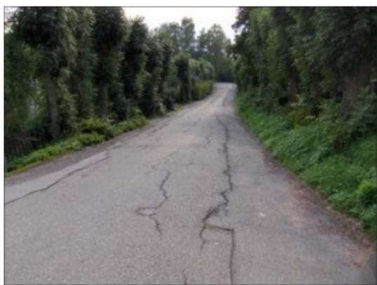
Langsgående sprekker i asfaltdekke.
